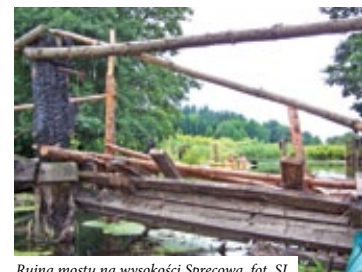
Ruina mostu na wysokości Spręcowa, fot. SJ
